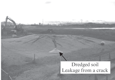
写真1 地表面隆起状況 (試験終了時)
